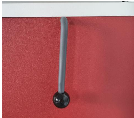
Abbildung 7: Kurzschlussklappenhebel in geöffneter Stellung.
